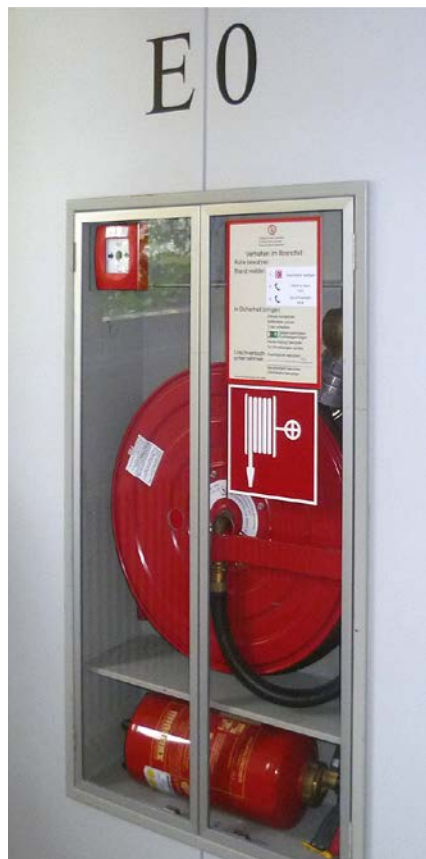
Durchdachte Planung ist wichtig: ein gut erreichbarer Wandhydrant
